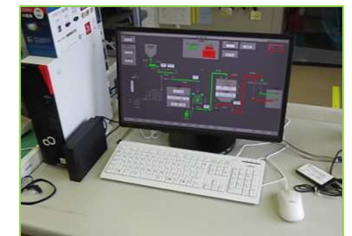
監視用PC(制御室)
